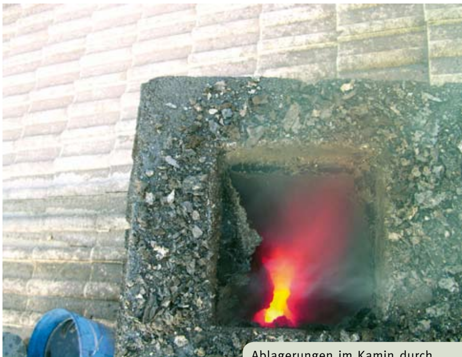
Ablagerungen im Kamin durch unsachgemäßes Heizen können bis zur Verstopfung führen
